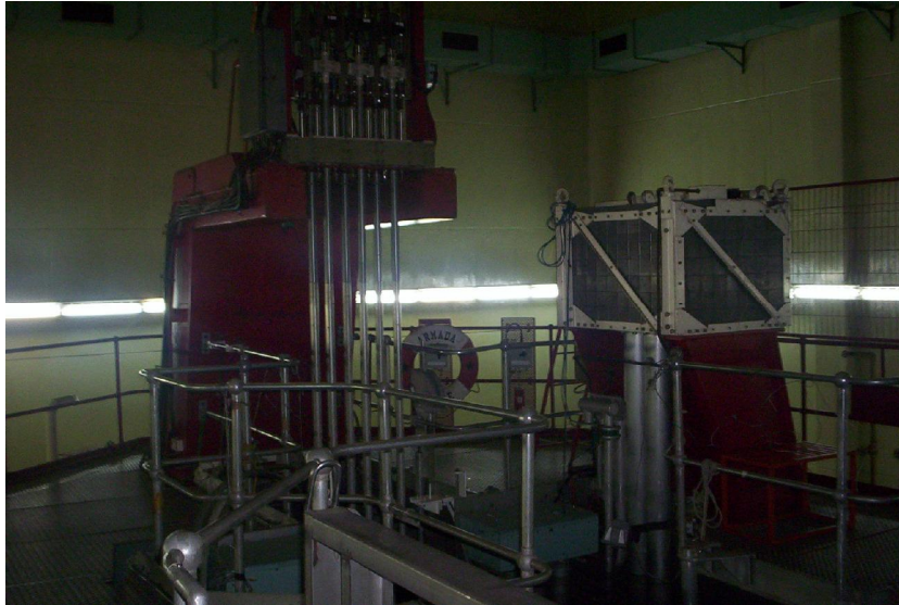
(Interior Torre del reactor principal)
