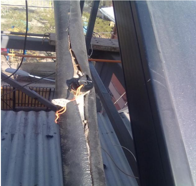
Figura 4.8.- Disposición del termistor en la cañería del panel.
