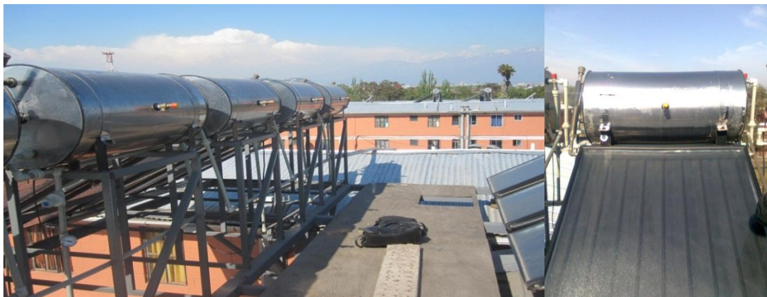
Figura 2.2.- Colectores solares en el techo del bloque EFGH.
