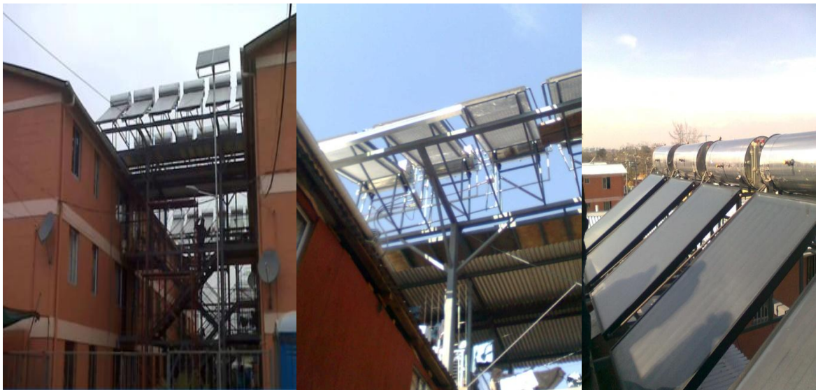
Figura 2.1.- Colectores solares instalados en los techos de los departamentos en el Barrio San Valentín.
