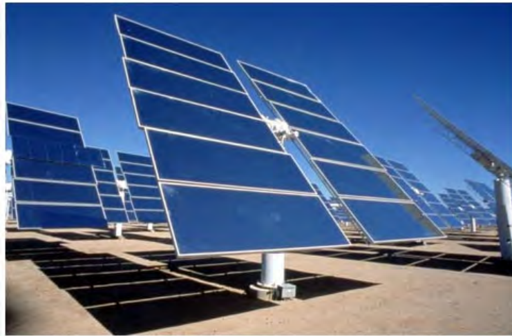
Figura 2: sistema fotovoltaico paneles de silicio policristalino.[4]
